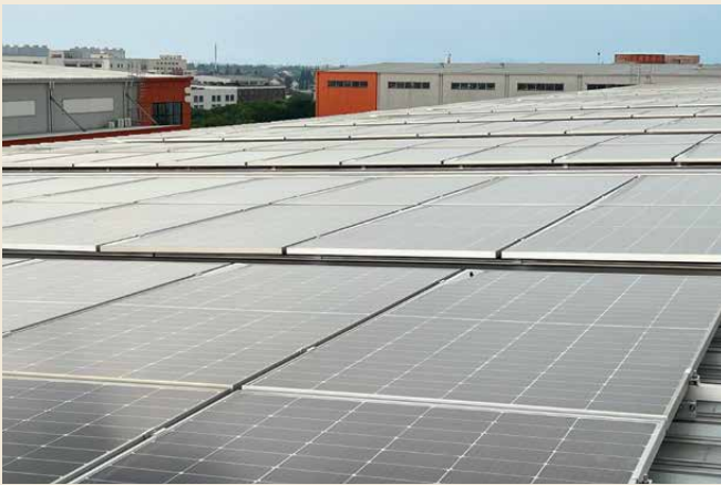
位于上海的丰树欧罗物流园区屋顶铺设的光伏设备。
