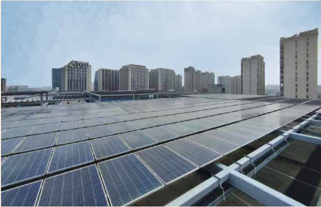
宁波怡丰汇的太阳能电池板安装在商场顶层的停车场。
